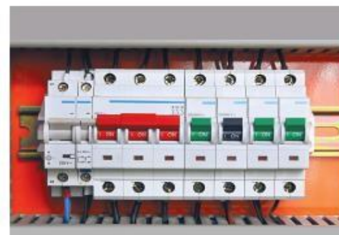
Рис. 2.58. Щиток с предохранителями
