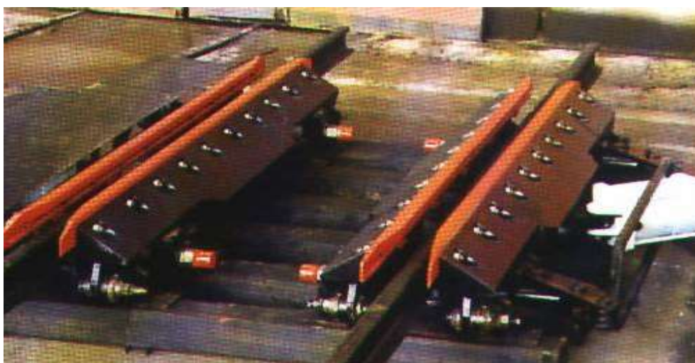
Рис. 3.13. Внешний вид вагонного замедлителя РНЗ-2М и ПНЗ-1 Вагонные замедлители РНЗ-2М и ПНЗ-1 применяют на станции Хабаровск II.
